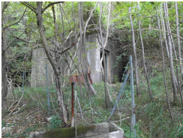
Fig.7.2 – Sorgente Acqua del Ciliegio: ingresso al bottino di presa.
